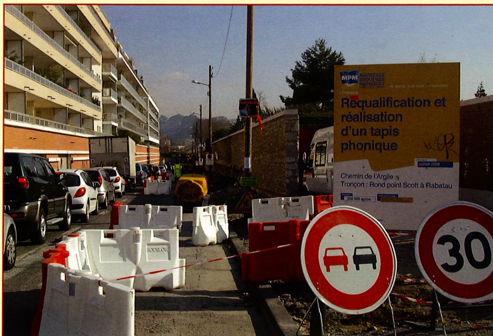
◀ Enfin les travaux de requalification et d'un tapis phonique du chemin de l'argile ont débuté le 16 février 2009 (avec un peu de retard...) et dureront jusqu'au 19 avril 2009.
